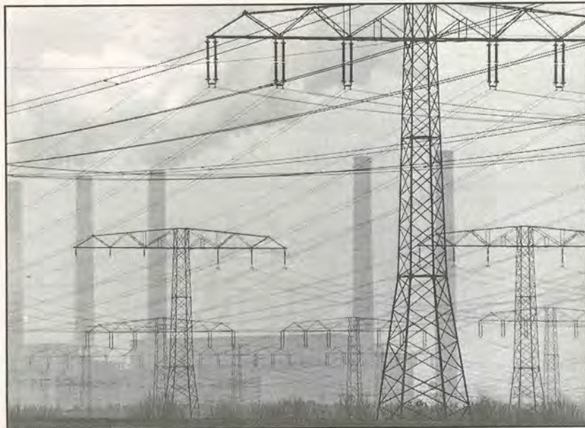
Rund 13 Mrd. Tonnen Kohle in der Lausitz können zu Strom und Fernwärme werden
