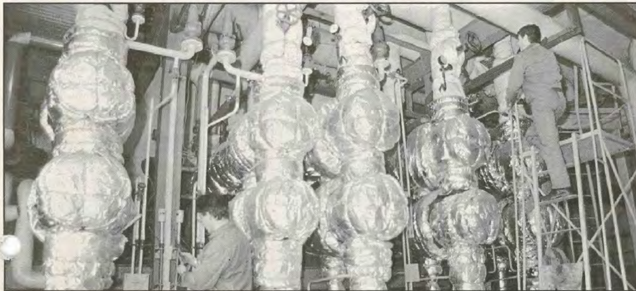
Fred Hochschild (l.) und Bodo Nürnberg kontrollieren die „Verpackung“ der Stadtwerke-Heizzentrale in der Bergstraße
