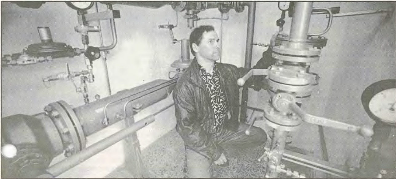
In der Übergabestation Bergstraße kommt das Gas der EMB für Premnitz an und wird von hier in das örtliche Netz eingespeist
