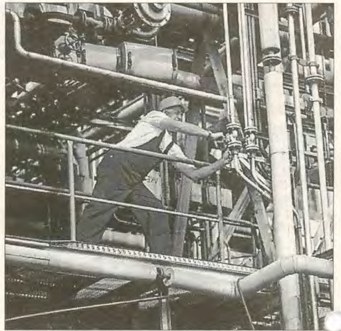
Mitarbeiter der Kattenbeck GmbH warten regelmäßig Industrieanlagen
