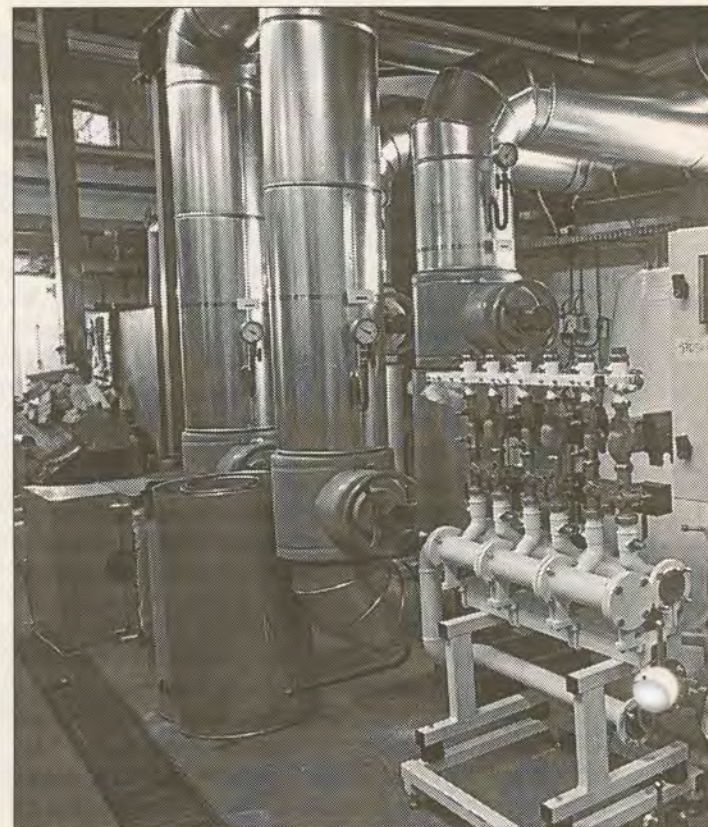
Moderne Nahwärmestationen beliefern die Wohnungen in den Altbauten
