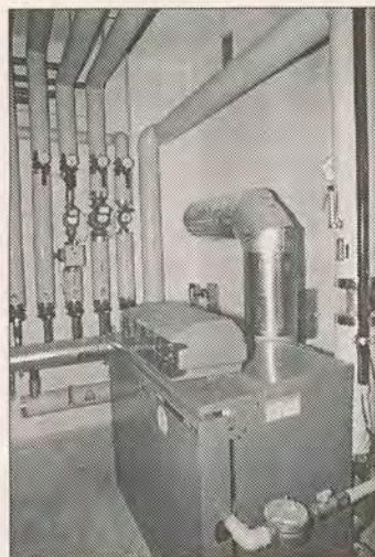
Eine Hauseinführung für Gas
