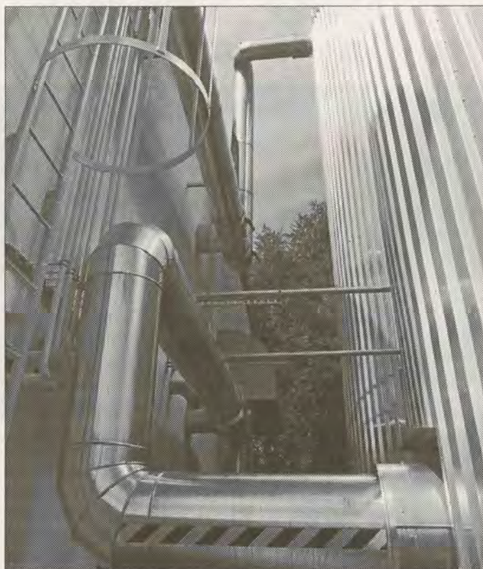
Mit leistungsstarken Blockheizkraftwerken – wie hier in Luckenwalde – nutzen Stadtwerke die technischen Möglichkeiten einer wirtschaftlichen und zugleich umweltfreundlichen Versorgung ihrer Kunden mit Wärme und Strom
