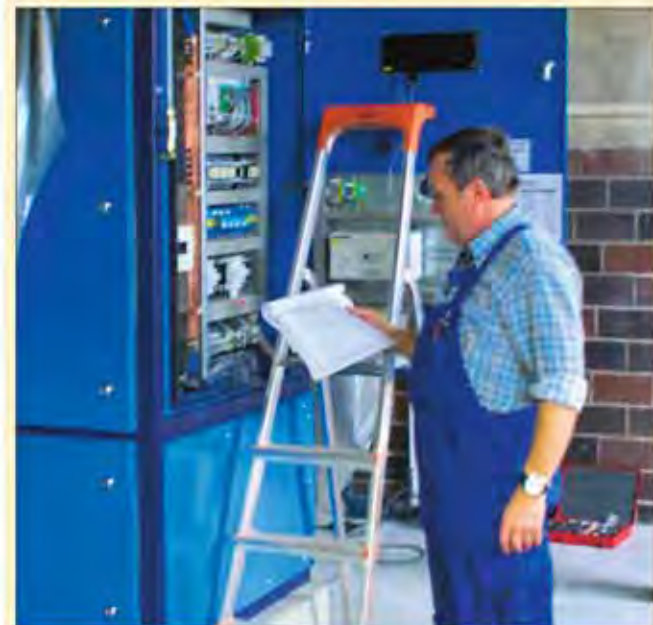
Letzte Überprüfung der neuen Kraft-Wärme-Kopplungsanlage und die Stromproduktion kann beginnen.
