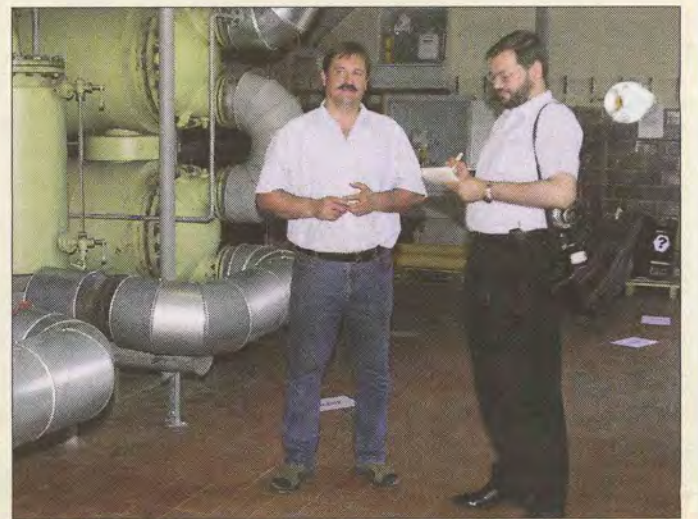
In der Fernwärmezentrale informierte sich die BRAWO über die Funktionsweise der 2001 modernisierten Wärmeübertrager.
