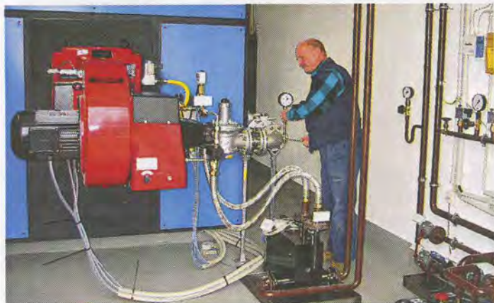
Seit Anfang 2002 wurde der Kessel an der Erdgastankstelle als Zweistoffbrenner für Öl und Erdgas umgerüstet. Als Werkkundendienstmonteur sorgt Frank Schmidt dafür, dass der Brenner auch immer einsatzbereit ist.
